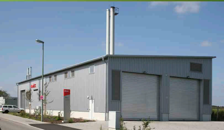
INSTALLATIONS DE CHAUFFERIE
